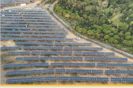
El parque solar promovido por Prenergy en Vidreres cuenta con una potencia pico de 3,4MWp.
