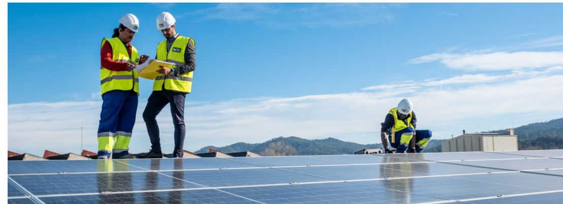
Instalación Fotovoltaica para Industrial Lamitor - Prenergy
